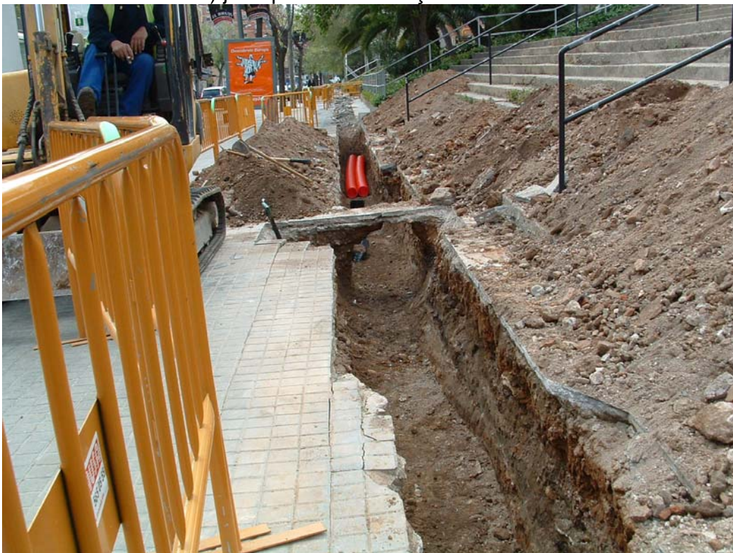
FOTOGRAFIA 6→ Vista de detall de l'obertura de l'inici de la rasa, a prop de les guixetes del Camp Nou de la Travessera de les Corts..
